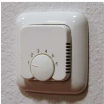
Die Heizung wird in den Monaten Mai bis September abgeschaltet.
