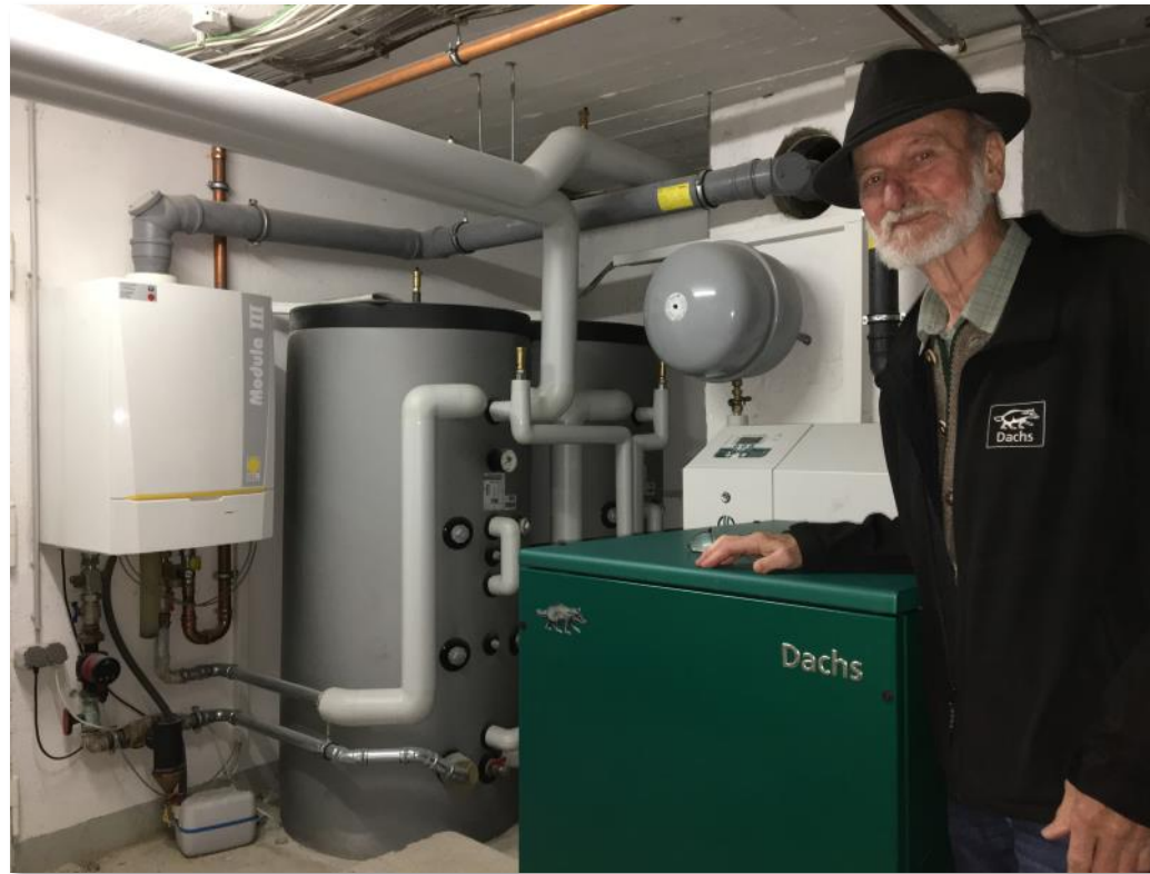
Franz Aßbichler, Umweltbeauftragter der Apostelkirche München-Solln, vor dem Blockheizkraftwerk
